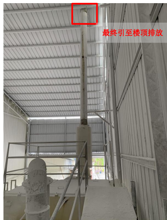
图 15 排气筒 DA008 及采样平台
