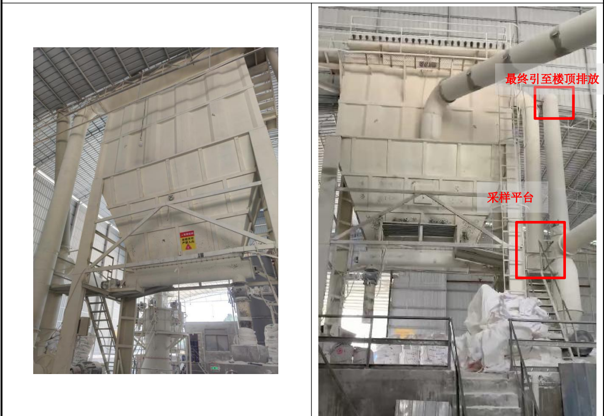
图 10 脉冲袋式除尘器（厂区南侧雷蒙磨机 4#）
