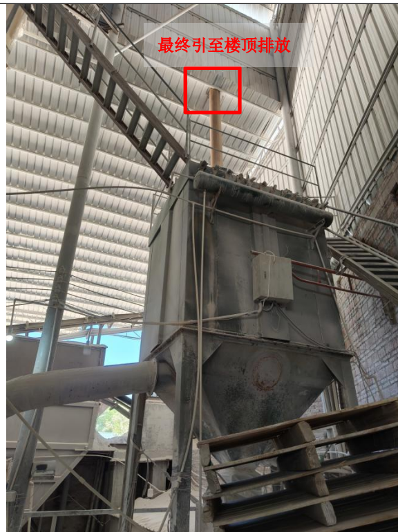
图 8 脉冲袋式除尘器（雷蒙磨机 2#）、排气筒 DA004 及采样平台
