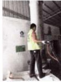
雷蒙磨机 6#废气 排放口 DA002
