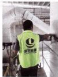
雷蒙磨机 3#废气 排放口 DA005
