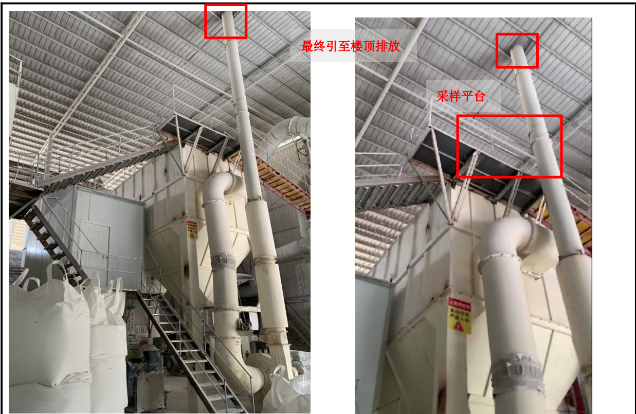
图 9 脉冲袋式除尘器（雷蒙磨机 3#）、排气筒 DA005 及采样平台
