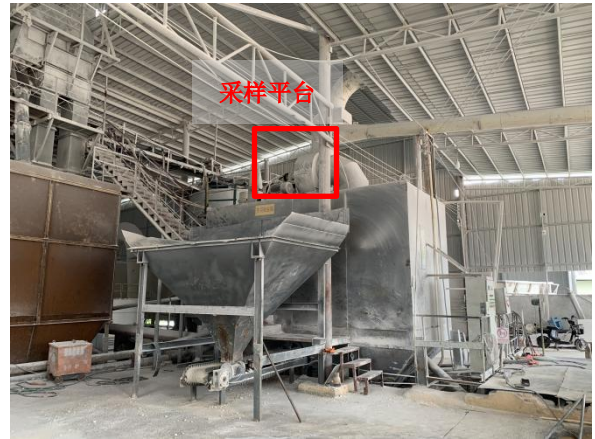
图2 排气筒 DA001 及采样平台
