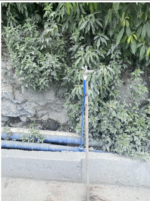
图片 5 水喷淋设施
